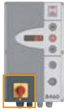
Hauptschalter Für alle externen Steuerungen
